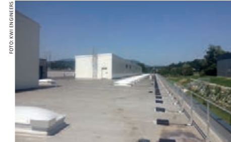
Die Lüftungszentrale gewährleistet konstante 24 Grad Raumtemperatur
