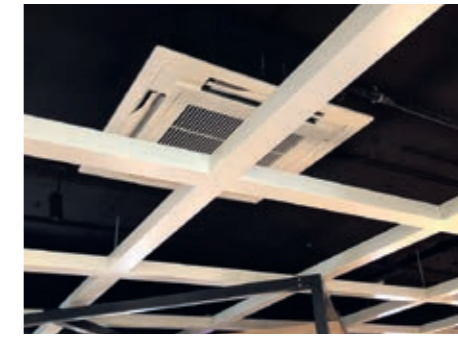
← Im ersten und zweiten Stock wurden die Kassettengeräte in der Zwischendecke platziert
