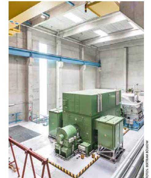
Maschinenhaus mit Generator und Turbine
